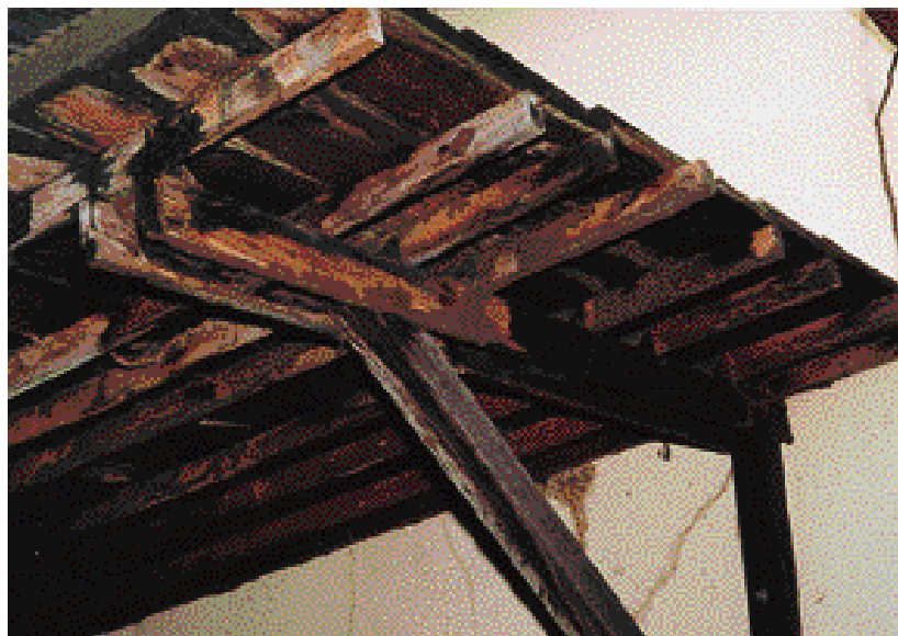
Photo 2. Toiture détériorée par Nasutitermes (Guyane). Roof damaged by Nasutiterme (French Guiana).
